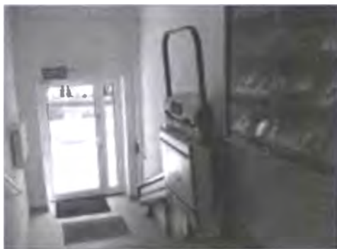
Winda dla niepełnosprawnych
